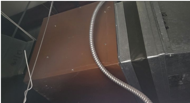
Inline Exhaust Fan above Break Area
