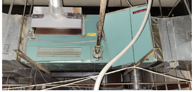
Gas Fan Unit above Break Area
