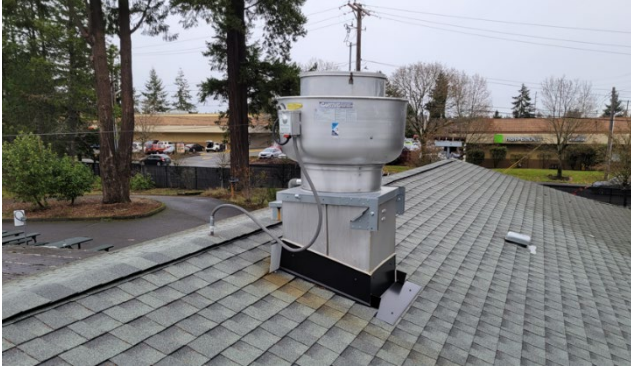
Kitchen Exhaust Fan
